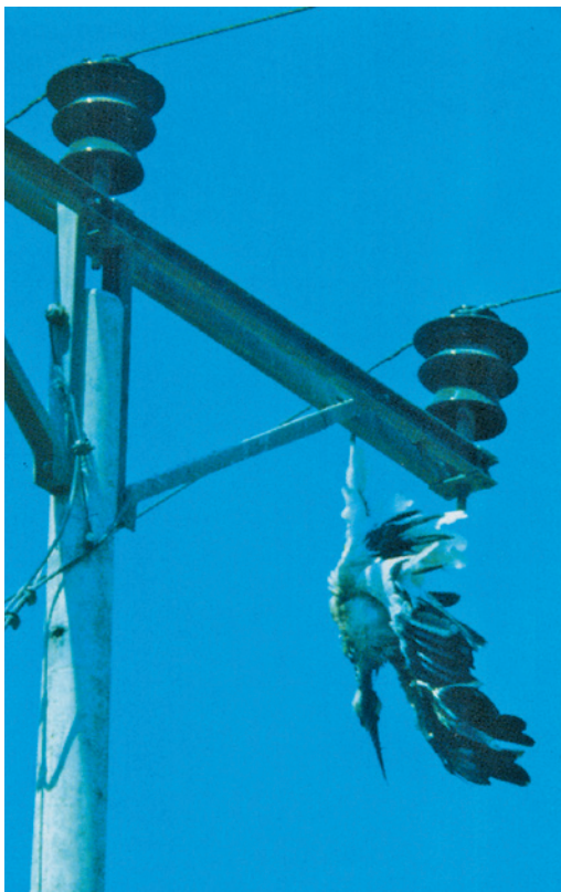
Slika 2: Betonski drog s podpornimi (pokončnimi) izolatorji je izredno nevaren vsem velikim pticam. Foto: G. Fiedler
